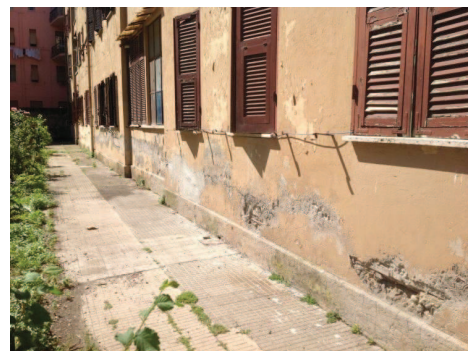
Foto 6 - Degrado delle parti basamentali
